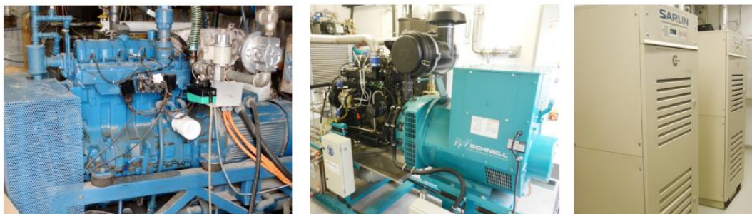
Kuva 28 Biokaasulaitosten IC-koneita: a) Sisun kotimainen 30 kWe otto-moottori Kalmarin maatilakohtaisella biokaasulaitoksella Laukaassa. b) 75 kWe diesel-moottori reaktorilaitoksella Leipzigissa. c) Kaksi 60 kWe mikroturbiinia kaatopaikalla Vaasassa. (Kuvat: Ari Lampinen)[9]
