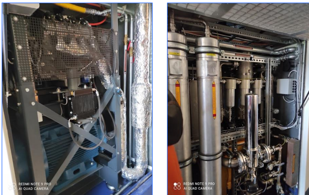
Kuva 29. Sähköntuotanto Picnus Oy:n tilalla biokaasun avulla. Polttomoottorissa poltettu, puhdistettu biokaasu tuottaa voimaa, jolla saadaan sähkögeneraattori tuottamaan sähköä koko tilalle. (Kuva Tapio Patrikainen)
