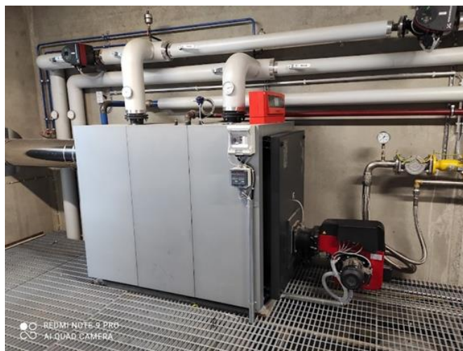
Kuva 45. Biokaasun käyttö lämmöntuotantoon. Oilonin kaasupolttimella varustettu lämmityskattila Markkolan tilalla. (Kuva: Tapio Patrikainen)
