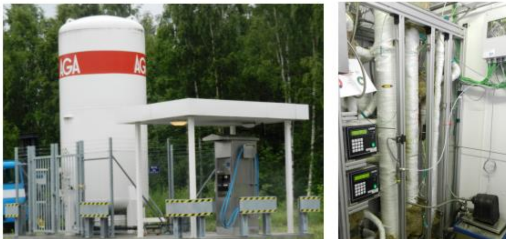
Kuva 56 Biokaasun sisältämän hiilidioksidin kehittyneitä hyödyntämistapoja: a) Kylmäkuljetusautojen LCO 2 -tankkauspaikka Lidköpingissä Ruotsissa. Biokaasulaitos, joka tuottaa LBG:tä ja LCO 2 :ta, sijaitsee puolen kilometrin päässä. b) Biokaasulaitoksen hiilidioksidia tuulimetaanin valmistuksessa hyödyntävä Sabatier-reaktori Fraunhofer-instituutissa Bad Hersfeldissa. (Kuvat Ari Lampinen) [9]
