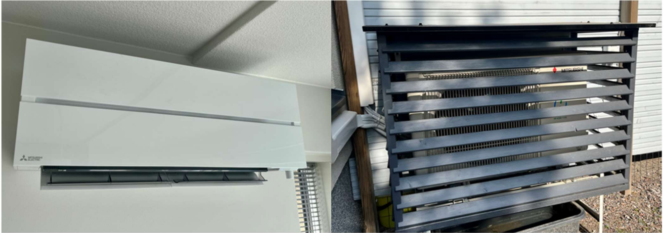
Kuva 7. Ilmalämpöpumpun sisä- ja ulkoyksiköt. [Arffman 2023]
