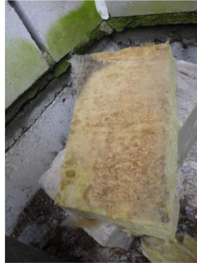
Kuva 192. Rakenneavauskohdassa RA-US2 ulkoseinän tuulensuojavillan alaosa on kastunut julkisivuun kohdistuvasta kosteusrasituksesta.
