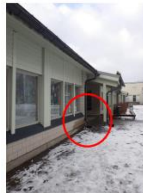
Kuva 310. Rästaskouruista vuotaa sulamisvesiä ulkoseinärakenteeseen US1.
