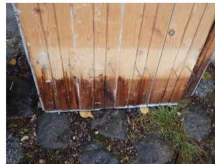
Kuva 204. Näkyvä kosteusrasitus julkisivupaneelin alaosan sisäpinnassa.
