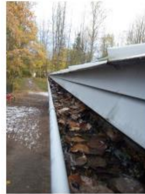
Kuva 308. Tukkeutunut rästäskouru rakennuksen itäisivulla.
