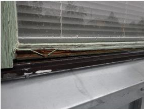
Kuva 74. Eteläpäädyn kolmannen kerroksen ikkunan ulkopuitteessa oleva lahovaurio.
