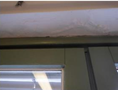
Kuva 76. Eteläsivun ikkunan yläpuolella on näkyvä kosteusvaurio toisen kerroksen ryhmäliikuntatilassa.
