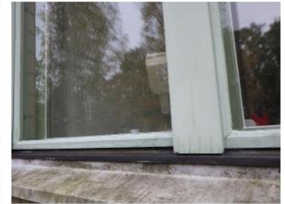
Kuva 86. Pohjoissivulla ikkunapellitykset ovat likaantuneet kaikkien kerrosten osalta. Kuva ensimmäisen kerroksen ikkunasta.
