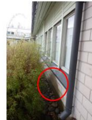
Kuva 311. Rästaskourulta vuotaa kattovesiä ulkoseinä- ja sokkelirakenteisiin.
