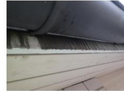
Kuva 309. Rästaskouruista on valunut vesiä rästäslaudoitukseen.
