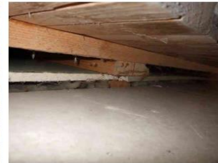
Kuva 203. Tuulensuojan ja sokkelin välissä on näkyvä rako, mistä ulkoilmavirtaukset pääsevät lämmöneristekerrokseen. Rakenneavaus RA-US1.
