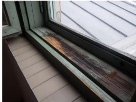
Kuva 75. Kolmannen kerroksen lahovaurioituneen ulkopuitteen kautta on tullut vettä karmivälisiin ja karmivälissä on näkyviä kosteus- ja mikrobivaurioita.
