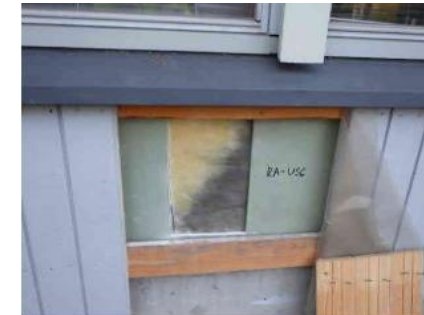
Kuva 209. Rakenneavaus RA-US6. Tuulensuojakipsilevyn takana oleva lämmöneristys on tummunut ulkoilmavirtauksista.
