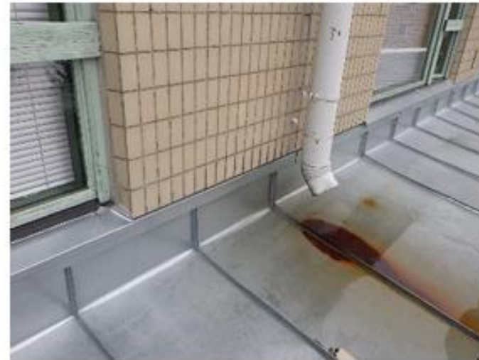
Kuva 132. Vuonna 2017 uusitussa peltikatteessa on korroosiovaurioita syöksyturvien kohdalla.
