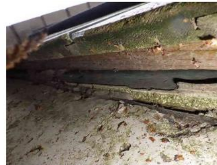
Kuva 202. Tuulensuojakipsilevyn alareunassa on näkyviä kosteusvaurioita. Julkisivupaneelin sahauspintaa ei ole maalattu ja siinä näkyviä kosteusvaurioita.
