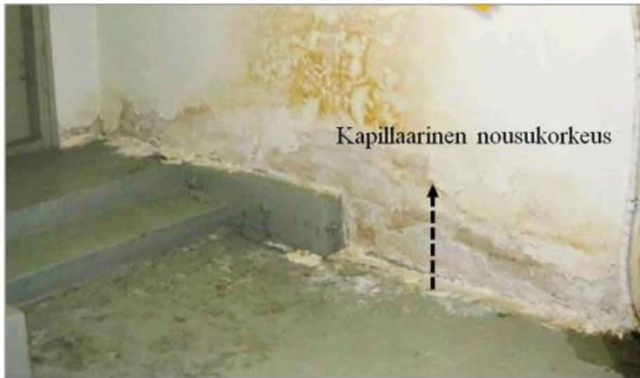
Kuva 5.19. Kapillaarinen maakosteuden nousu on johtanut tasoitteen ja maalin irtoamiseen väliseinän alaosasta. Kuva: J. Ahokas, Vahanan Oy.
