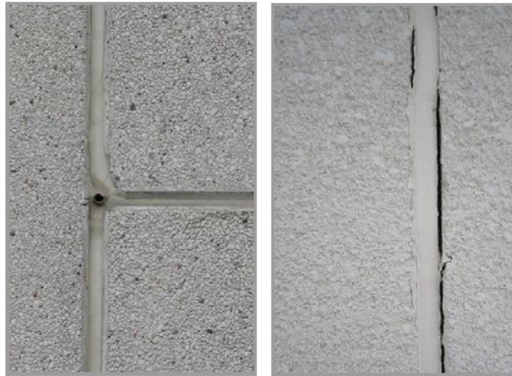
Kuva 7.19 Vasemman puoleisessa kuvassa saumat ovat tiiviitä ja elementtien alanurkissa on vedenpoistoputket. Oikeanpuoleisen kuvan sauma on epätiivis. Kuvat: M. Pitkäranta ja K. Laine, Vahanen Oy.
