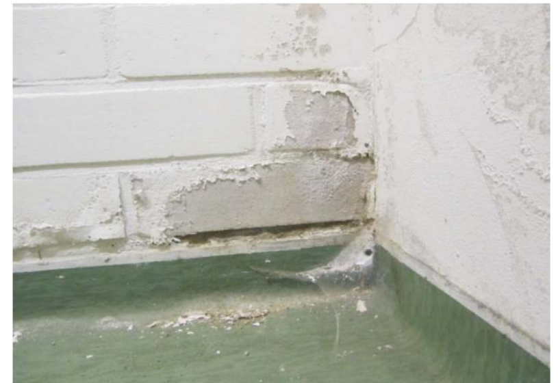
Maali hilseilee, pinnat ja muovimaton tausta homehtuu
